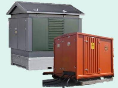
Foto: Møre Trafo, Norsk Transformator
